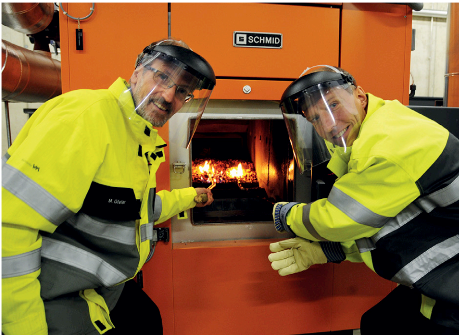
Stadtrat Matthias Gfeller und Stadtwerk-Direktor Markus Sägesser beim Anfeuern einer Holzschmied-Heizzentrale.
