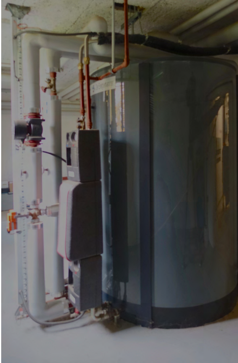
Heizwasserspeicher mit Solaranbindung (1 x pro Haus)
