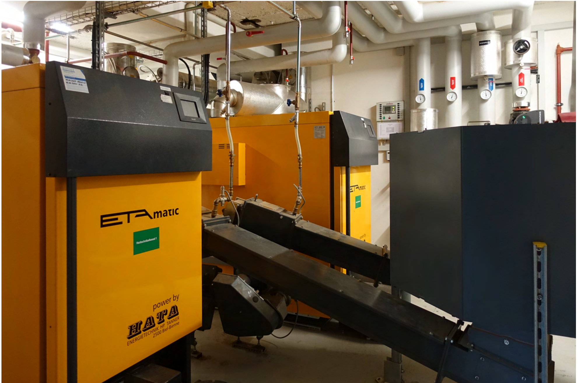
Zwei Heizkessel für Holzschnitzel mit Zwischenbehälter(rechts) und Förderschnecken (Mitte)
