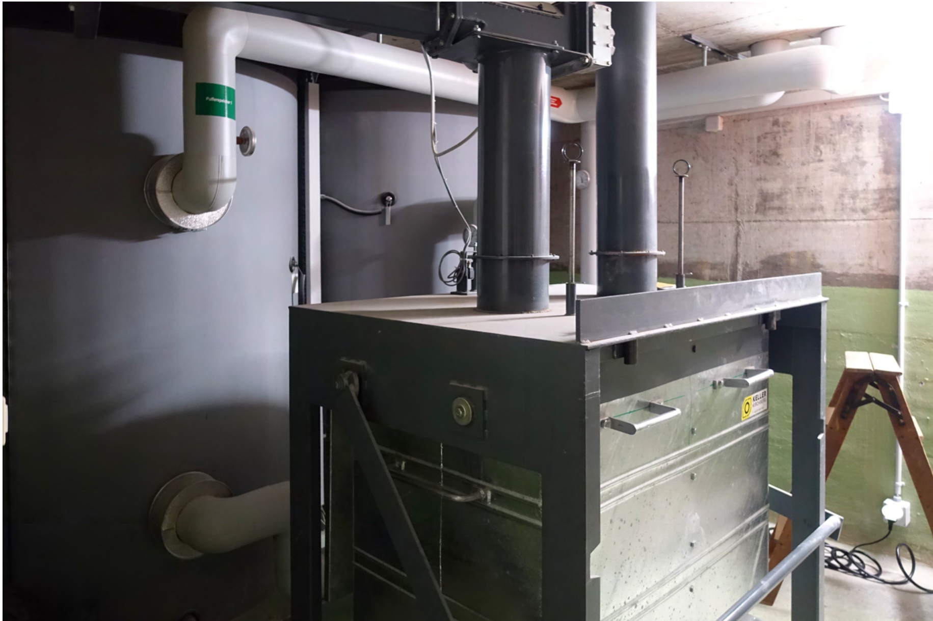
Pufferspeicher und Aschestation mit Aschecontainer
