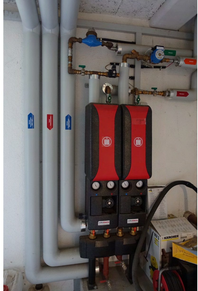
Wärmetauscher zur Erzeugung des Brauchwarmwassers (1 x pro Haus)
